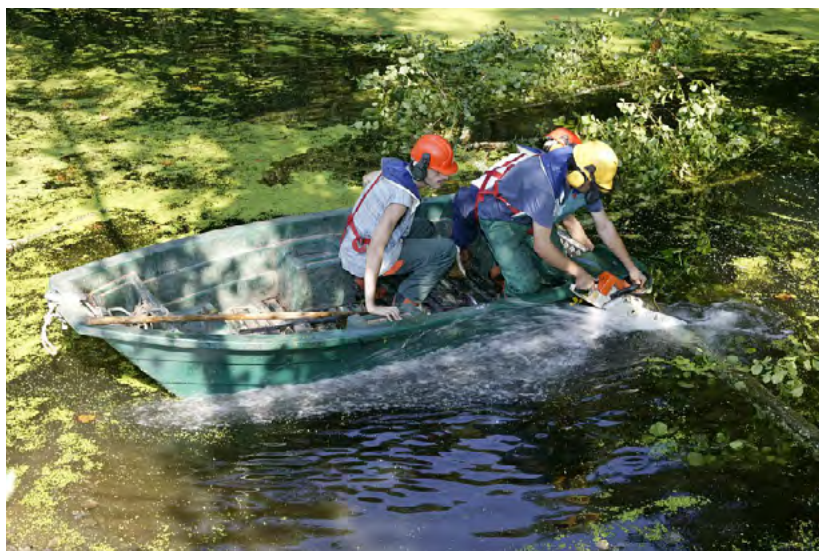
Photographie 1. Travaux d'entretien de rivière : retrait d'embâcle faisant obstacle à l'écoulement des eaux
