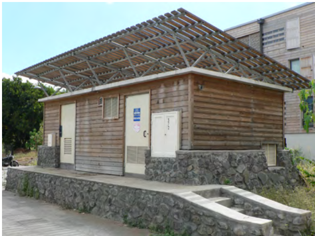
Photographie 14. Surélévation d'un transformateur électrique à la cote de la zone inondable à Saint-Paul (Réunion)
