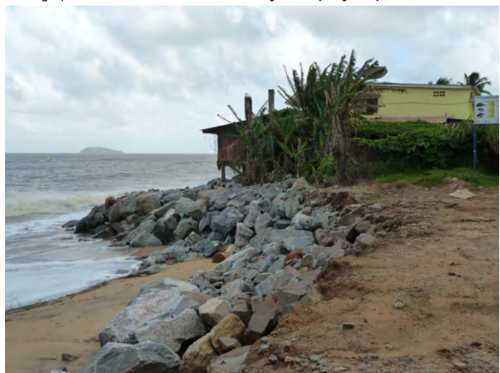
Photographie 9. Érosion du littoral à Cayenne (Guyane)
