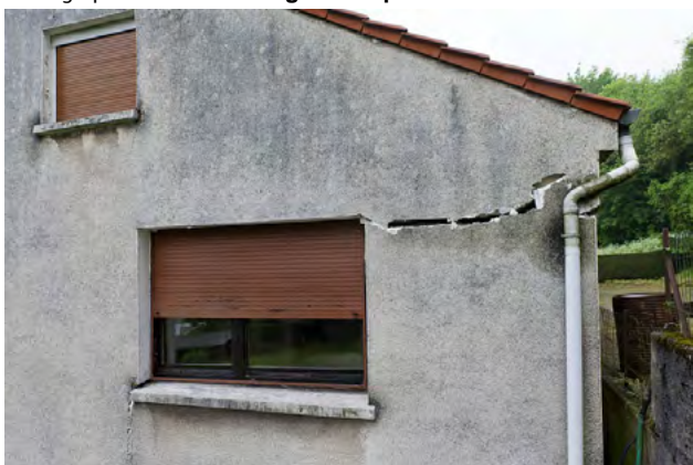
Photographie 5. Fissure engendrée par l'aléa sécheresse
