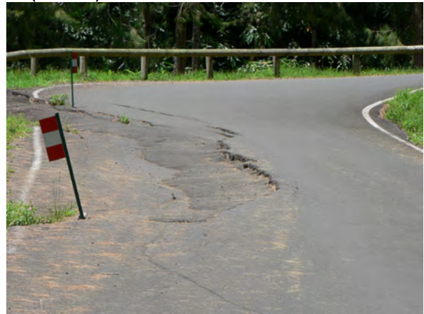
Photographie 8. Glissement de terrain sur la route de Salazie (Réunion)
