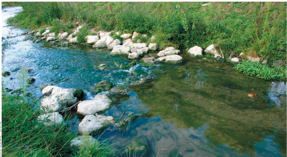
Exemple d'un seuil créé sur le Trec en 2008, dix mois après les travaux.
