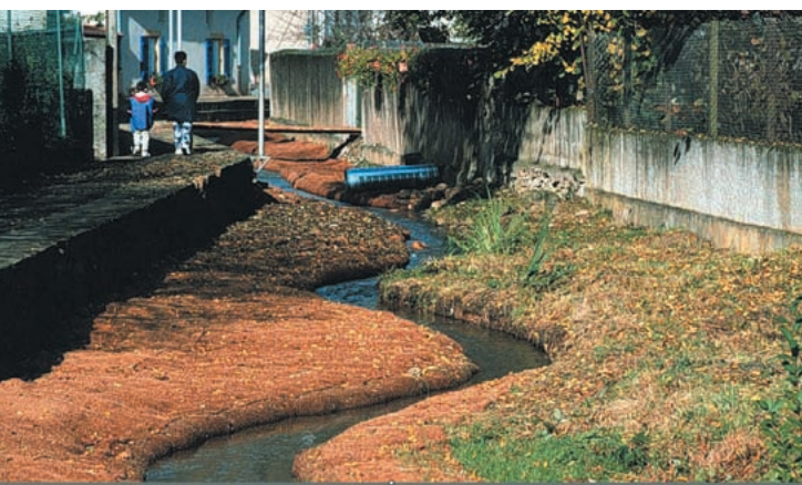
Le ruisseau de Montvaux pendant les travaux de restauration. Pose du géotextile en fibre de coco (octobre 1999).
