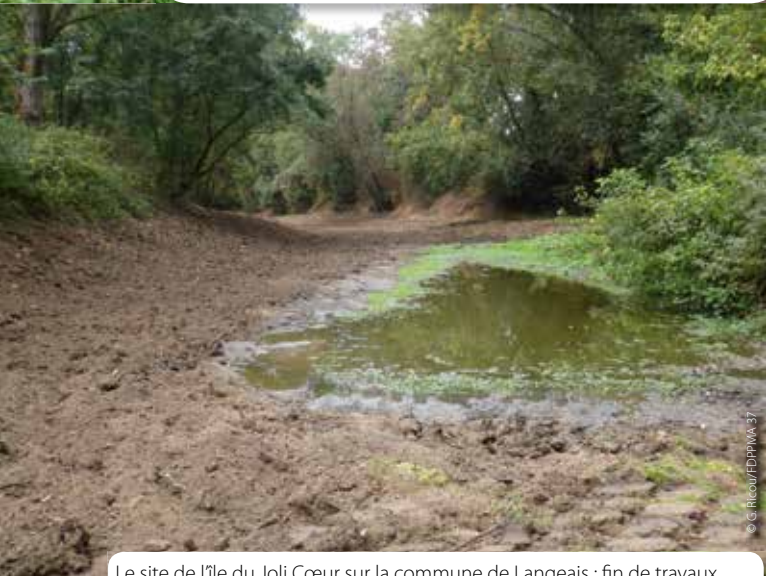
Le site de l'île du Joli Cœur sur la commune de Langeais : fin de travaux.
